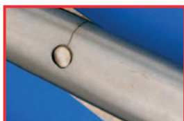
Vlasová trhlina v oblasti kloubu nůžek
