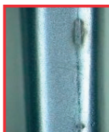
Detail elektrolytické koroze
