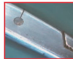
Povrchová trhlinka v nýtu kloubu
